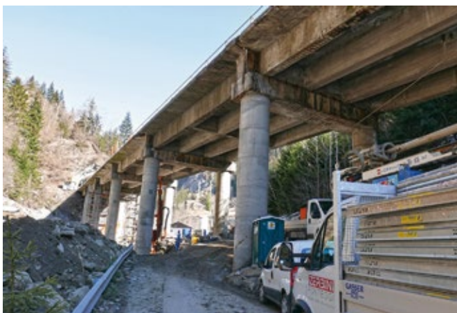
Die Schäden an der Brücke sind mit bloßem Auge sichtbar: Das Tragwerk muss komplett ausgetauscht werden.
